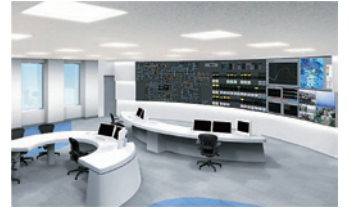
電力系統監視制御システム Supervisory Control And Data Acquisition Systems (SCADA)
