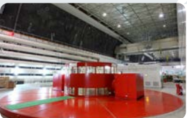
葛野川発電所 (東京電力リニューアブルパワー株式会社様)
