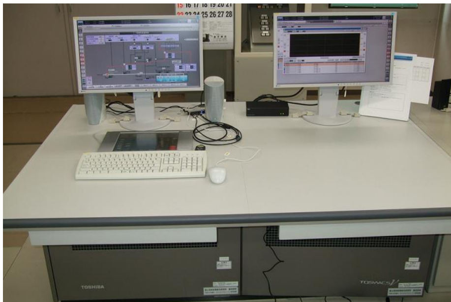
写真4 LCD 監視制御装置
