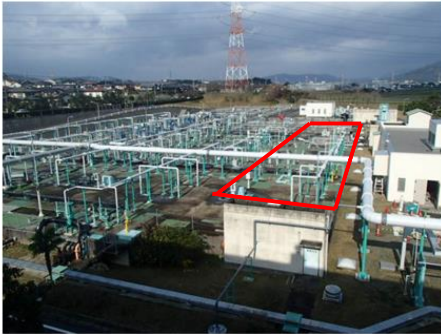
写真1 実証施設全景（I系水処理設備（赤枠の範囲））
