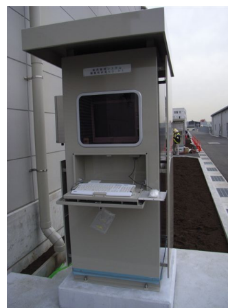
写真1 屋外型収納盤
