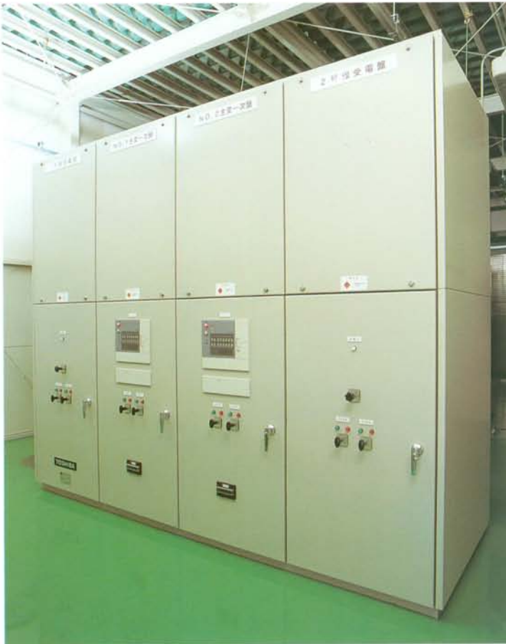
■ 固体絶縁スイッチギヤ (常用線・予備線受電 主変一次VCB)
