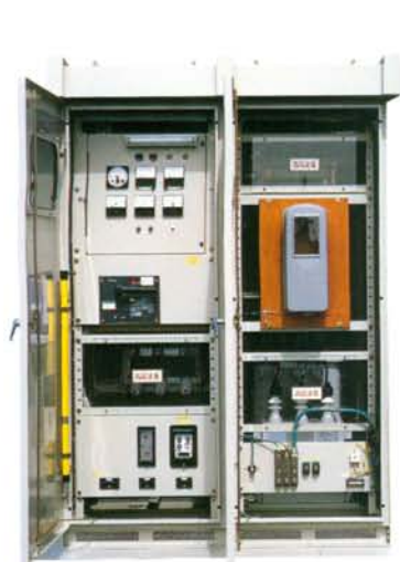
引込・受電盤
