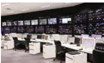
本线运行管理系统 (东武铁道株式会社)
