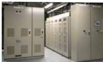
用于直流铁道电力系统 SCiB™ 配备 再生电力存储系统 (冲绳都市单轨株式会社)
