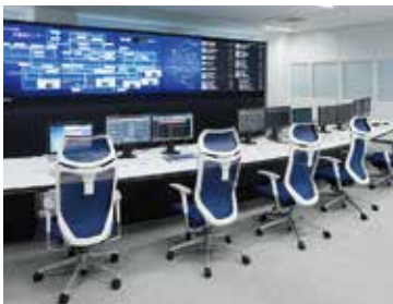
上下水道监控系统
