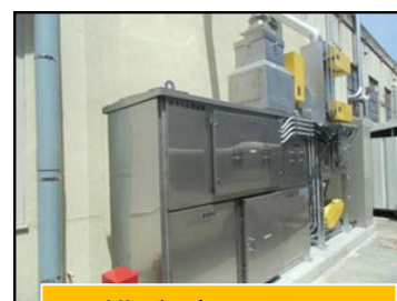
排ガス処理装置
