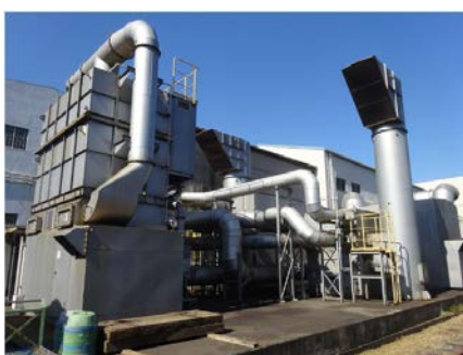
VOC 物質除去装置（分離・濃縮・焼却施設）
