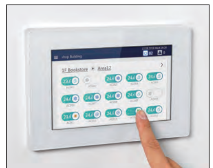
128系統空調コントローラ画面
