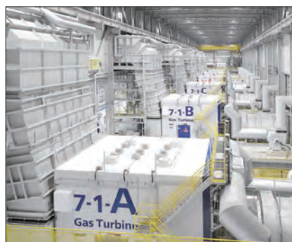
西名古屋火力発電所7号系列
