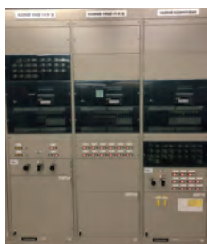
本体装置と分配装置 Server panel and interface panels
