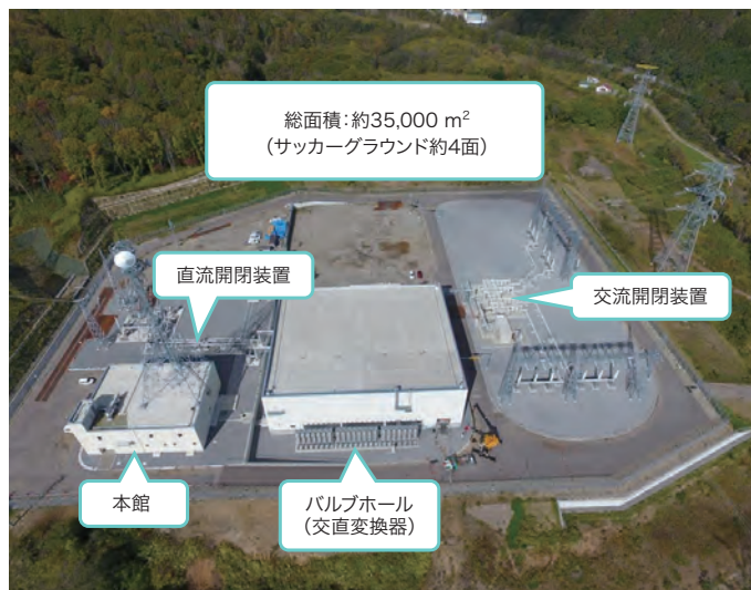
北斗変換所 Hokuto Converter Station
