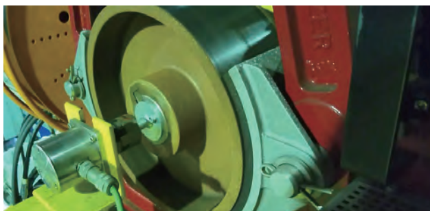
ウエアラブルカメラシステムによるクレーンブレーキの確認
