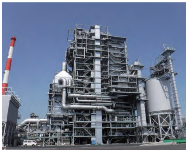
(株)シグマパワー有明 三川発電所 Mikawa Power Plant of SIGMA POWER Ariake Corporation
