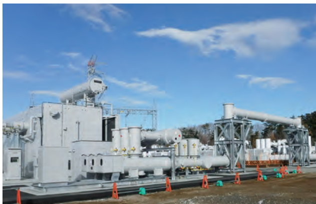
都路変電所に設置した500 kV 変電設備
