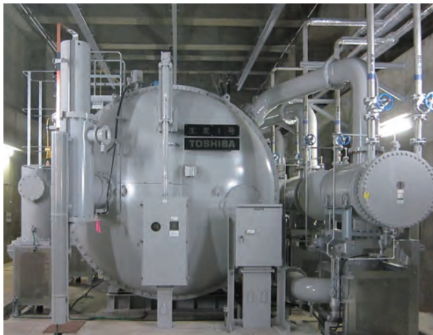
墨東変電所 300 MVA GIT
