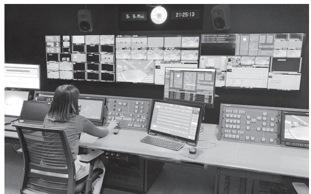
図1. 地上系設備のマスターシステム監視室
