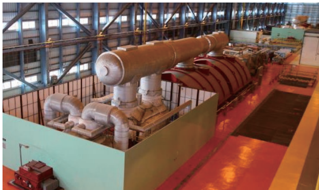
蒸気タービン発電機
