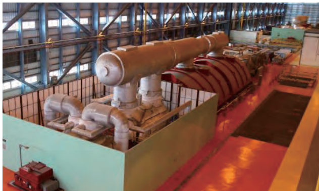
蒸気タービン発電機 Steam turbine generator
