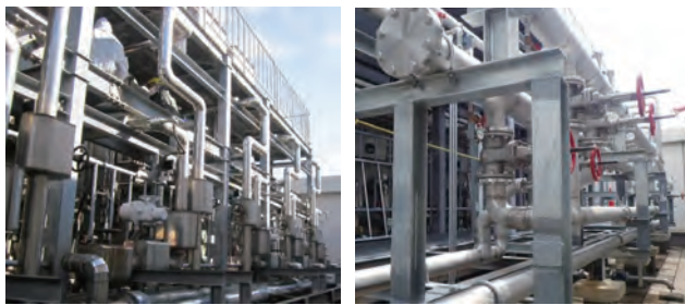
リプレース前後の水冷却設備
