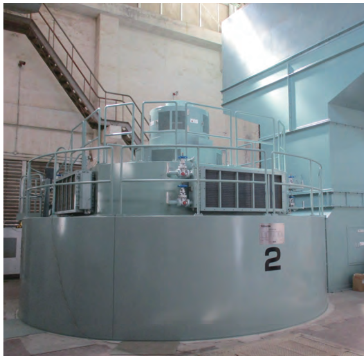
水車発電機 Hydraulic turbine generator
