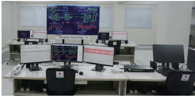
変電所運転訓練シミュレーター
