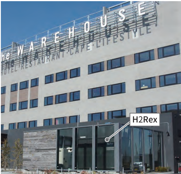
川崎キングスカイフロント東急REIホテルに設置された100 kW級H2Rex 100 kW H2Rex™ pure hydrogen fuel cell system installed at Kawasaki King Skyfront Tokyu REI Hotel
