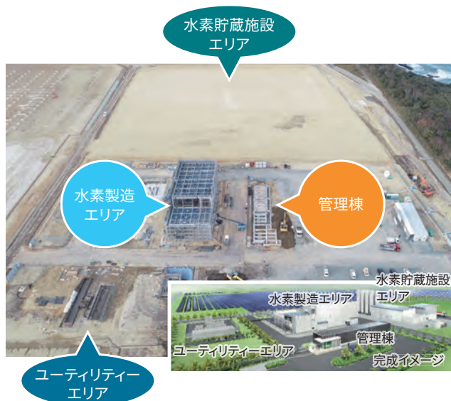
建設工事が開始された水素プラント Installation site of large-scale hydrogen energy system using renewable energy
