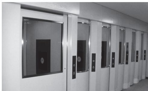
図2. 出入管理ゲートの設置例
