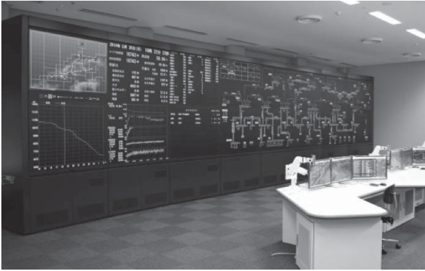
図6. CIMを適用した給電システムのコントロール室
