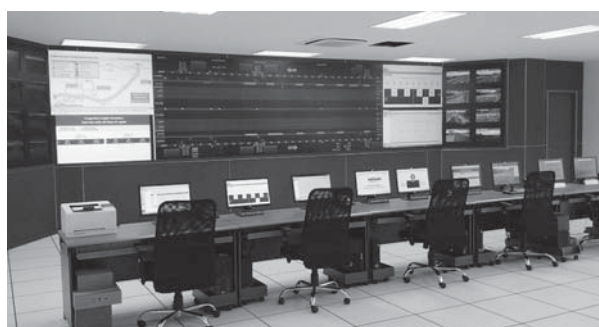
図1. ベトナム高速道路公社 ITS設備 — ベトナム高速道路公社に納入したITSの交通管制室である。
