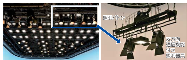
(a) スタジオ内照明設備
