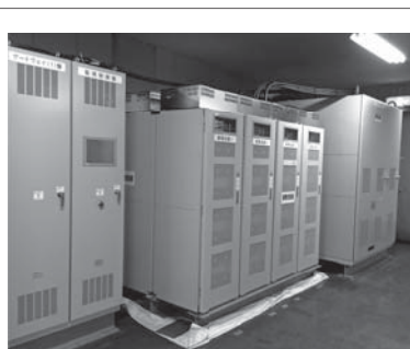
図9. 回生電力貯蔵装置 — 電力の安定供給 を実現するとともに、車両回生電力失効の防 止やピークカットなどを行い、様々な用途に対 応できる。 Traction energy storage system
