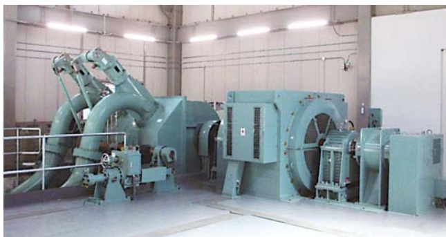
東京発電(株) 白田川発電所 水車発電機
