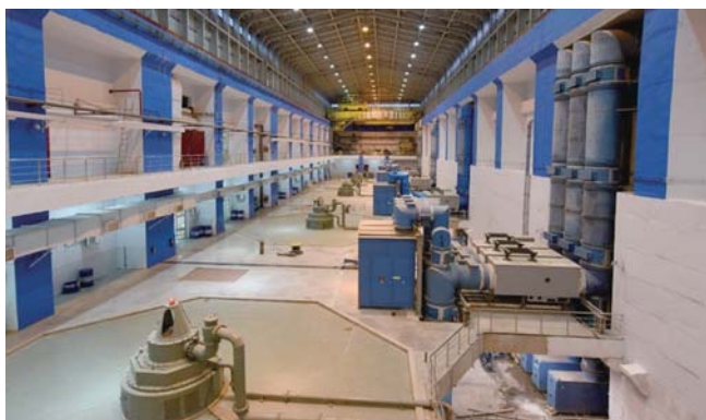
コルダム水力発電所 発電機室
