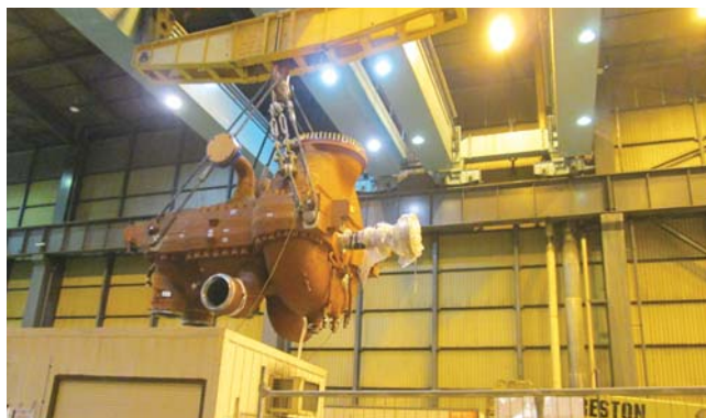
サイト据付時の高中圧タービン
