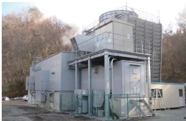
わいた地熱発電所
