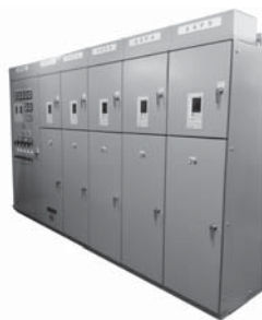
図2. 御船蔵町変電所 直流スイッチギヤー 海外ニーズを取り込んだHS5形を国内で初めて納入した。
