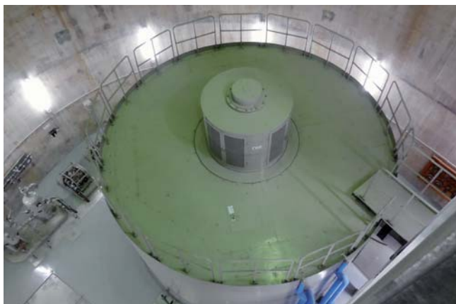
中部電力(株) 徳山水力発電所 2号機の水車発電機
