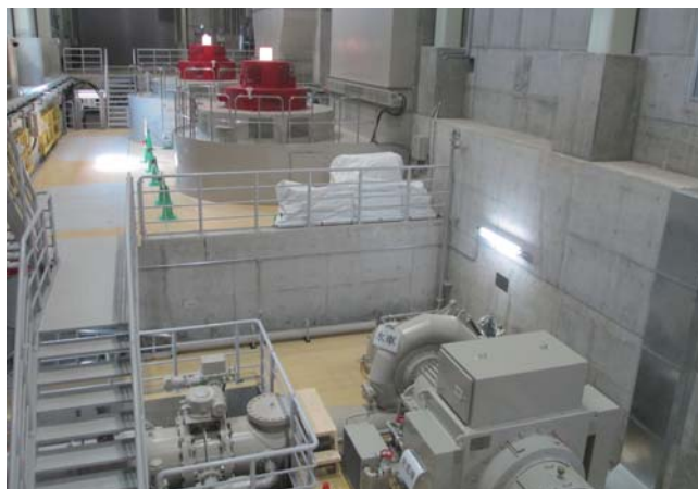
電源開発(株) 胆沢第一発電所の立軸水車発電機、並びに岩手県企業局 胆沢第三発電所の横軸水車及び発電機
