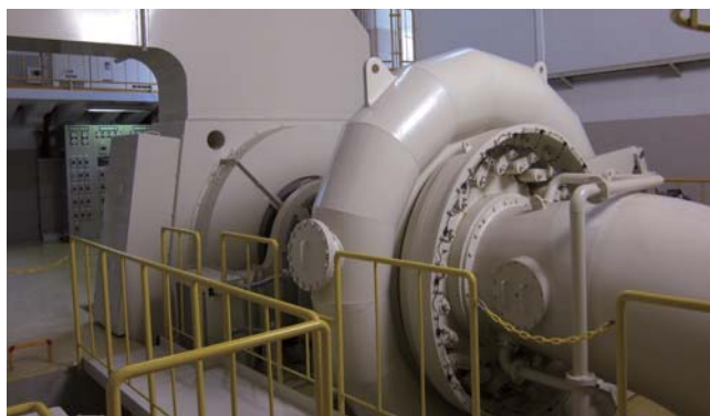
イビデン(株) 川上発電所の水車及び発電機
