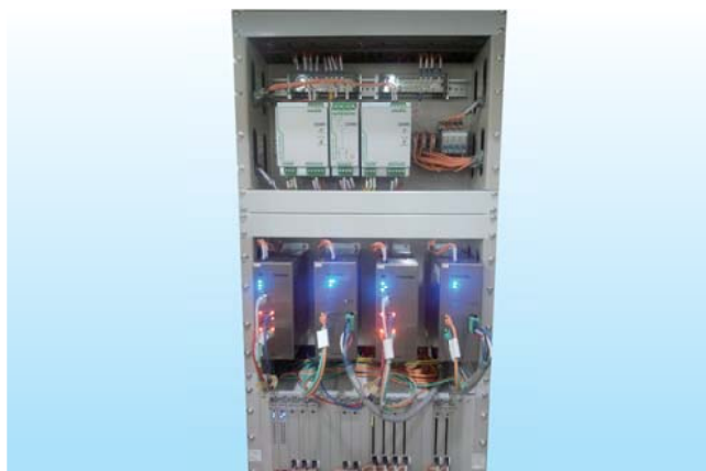
アマタ B グリムパワー社 第4, 第5発電所用制御システムのTOSMAP-DS™/LXコントローラ
