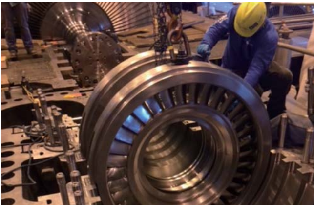
オムタワ石炭火力発電所の高圧タービンロータ
