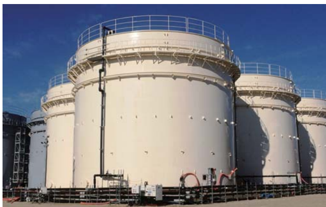
現地溶接型タンク
