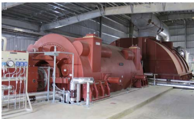
営業運転を開始した米国 ファーガソン発電所の STG (195.1 MW) Steam turbine generator for Thomas C. Ferguson Power Plant, U.S.A.
