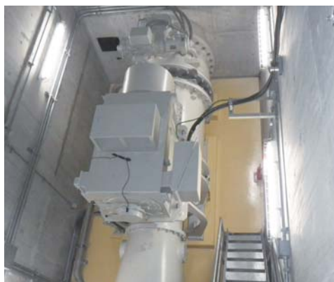
東北電力(株) 飯野発電所の水力発電設備
