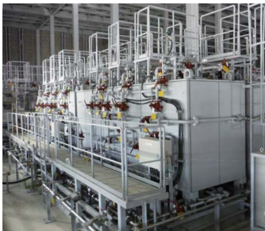
増設多核種除去設備 吸着塔スキッド
