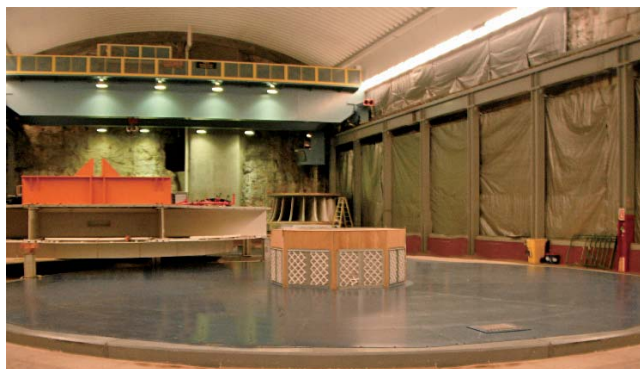
バウンダリー発電所の55号機 発電機
