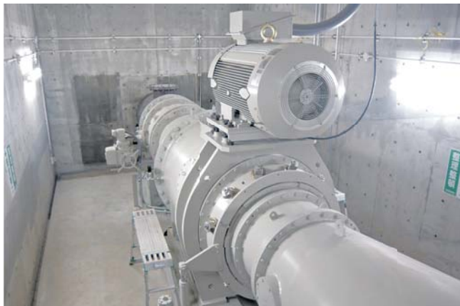
胆沢第四発電所の水力発電設備
