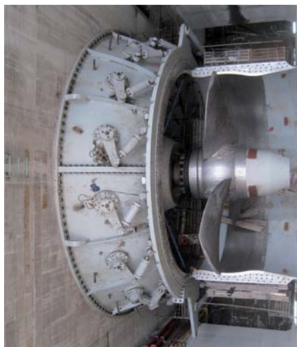
石虎塘発電所の現地組立ランナ
