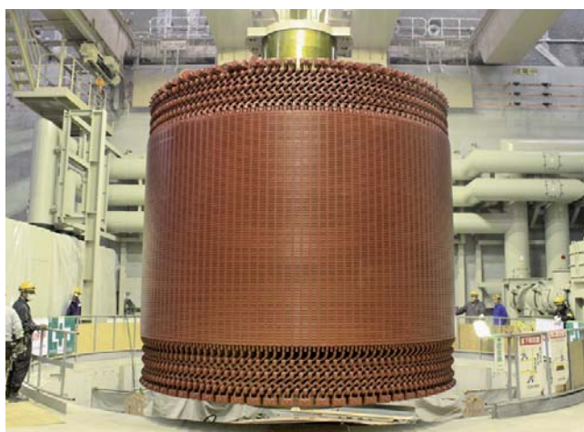
京極発電所1号機の発電電動機回転子
