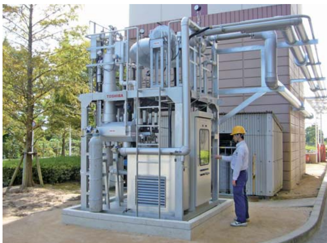
CCU試験設備
