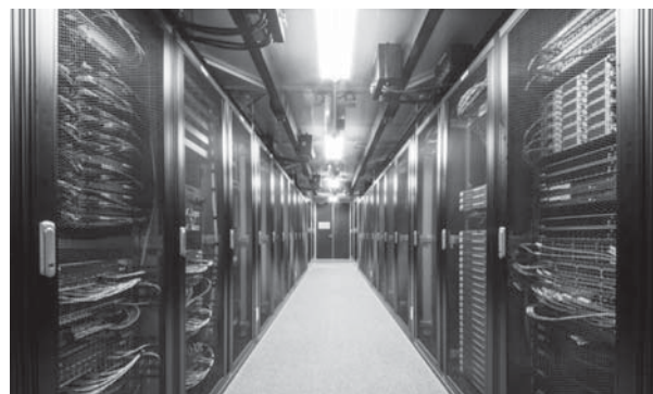
図2. 屋内モジュール型データセンターのモジュール内部 — ICT機器をラックに収納し、高効率の空調システムにより省エネを実現する。
