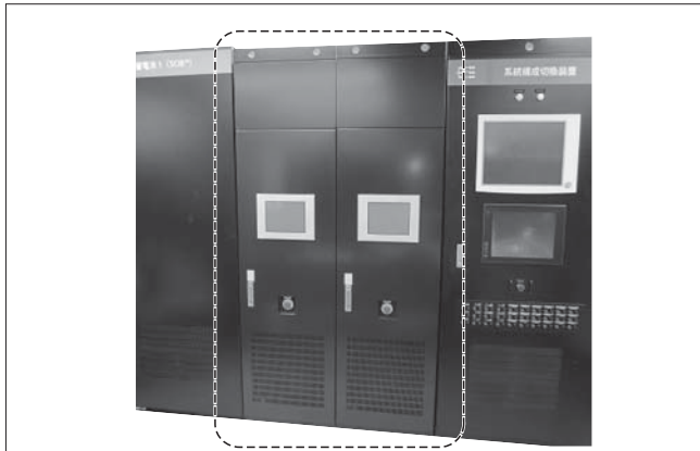
図2. 定置型蓄電池システム (6.6 kW×2台) — 今回導入した蓄電池システムは、SCiB™の20 Ahセルを採用した。 Battery energy storage system equipped with SCiB™ battery modules
