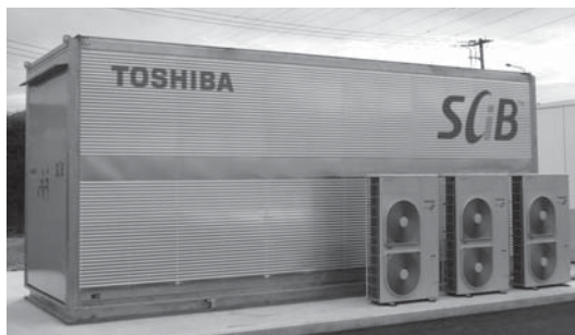
図8. YSCPでの蓄電池SCADA実証用300 kW-100 kWh大規模蓄電池システムのパッケージー蓄電池システムをパッケージ化してコンバクトに収納することで、輸送据付が容易となるとともに、MW級への展開も可能になる。
