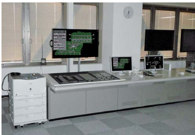
航空灯火電力監視制御システム
