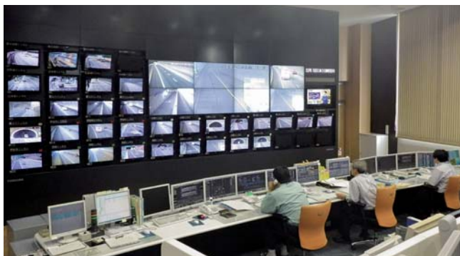
施設制御システム（東京支社 道路管制センター）
