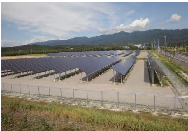
新潟東部太陽光発電所（2号系列）
