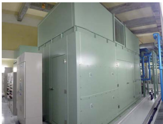
新潟市 中部下水処理場 消化ガス発電設備 Sewage gas power generation system of Chubu Sewage Treatment Center, Niigata City
