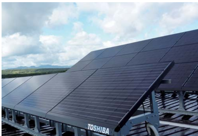
住宅用太陽光発電モジュールの設置例
