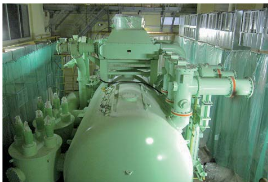
スコルコボ変電所 63 MVA GIT
