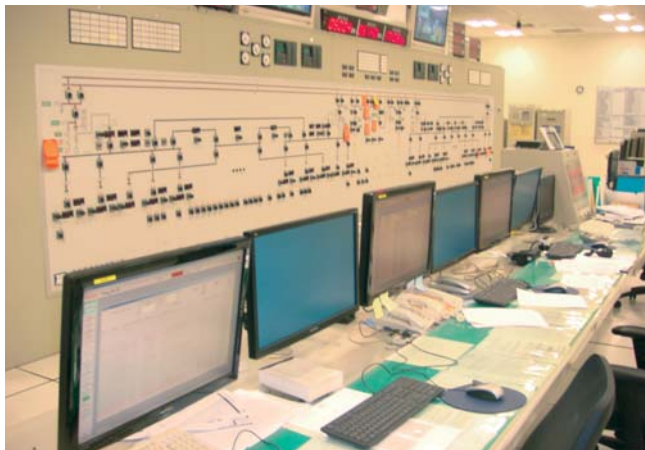
豊徳火力発電所1号機の中央制御操作室
