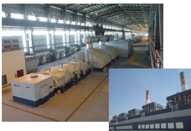
蒸気タービン・発電機設備
