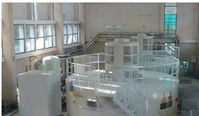
インド ウミアム Stage- II 発電所の1, 2号水車発電機
