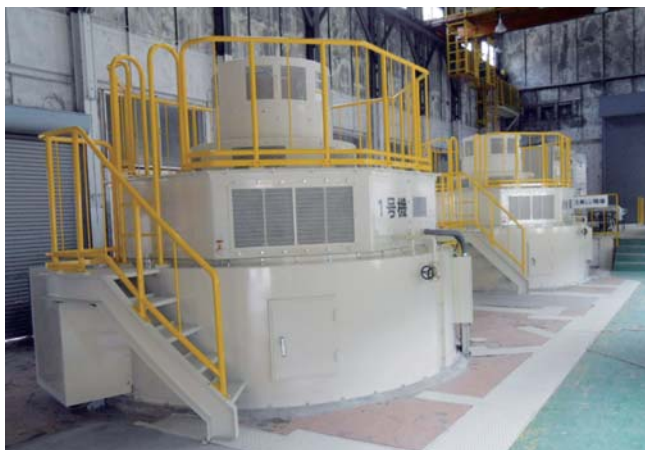
イビデン(株) 広瀬発電所の1, 2号水車発電機
