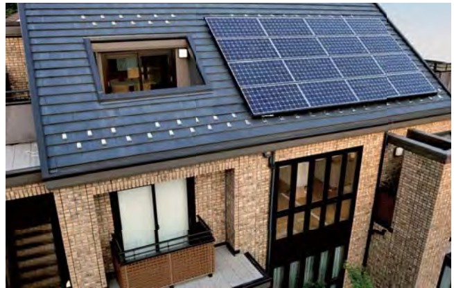
東芝の住宅用 PV システム 設置例
