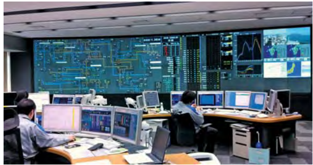
中央給電指令所 指令室
