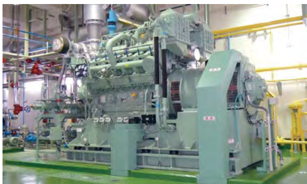
那覇浄化センター NO.4 消化ガス発電装置 NO. 4 sewage gas generation system at Naha Sewage Treatment Center, Okinawa
