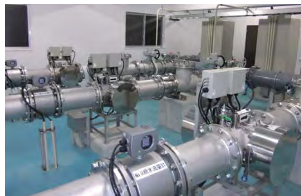
宮下浄水場に設置した中圧紫外線照射装置 TOSAQLEAR™
