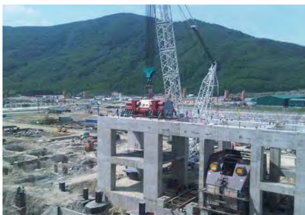
1号機発電機のスータオンベース
