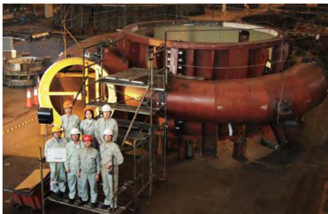
北海道電力(株) 京極発電所 1号機ケーシング
