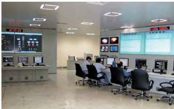
中央監視制御室のDCSオペレーターステーション
