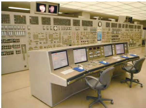
川越火力発電所向け オペレーターステーション
