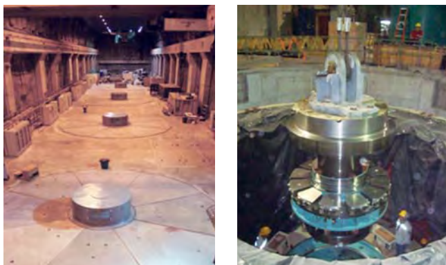
発電機全景 (左)とスラスト軸受組立 (右)
