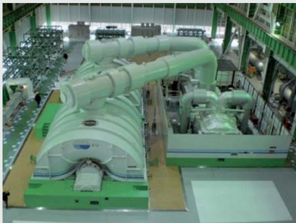
▲ 蒸気タービン Steam turbine
