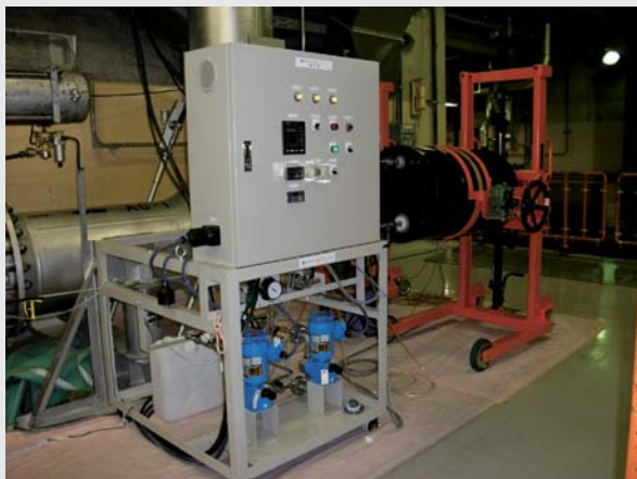
▲ 酸化チタン注入装置 Titanium oxide (TiO 2 ) injection skid
