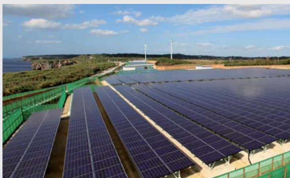
▲ 沖縄電力(株) 宮古島メガソーラー実証研究設備 Miyako Island Mega Solar facility of The Okinawa Electric Power Co., Inc.
