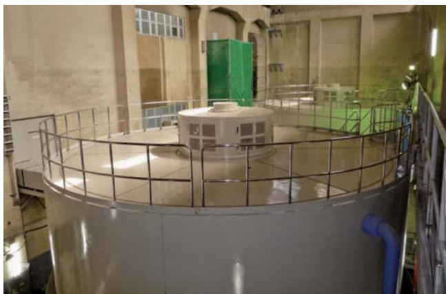
九州電力(株) 上椎葉発電所の1, 2号発電機
