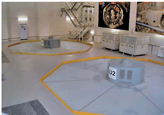
ボゴン発電所の1, 2号発電機
