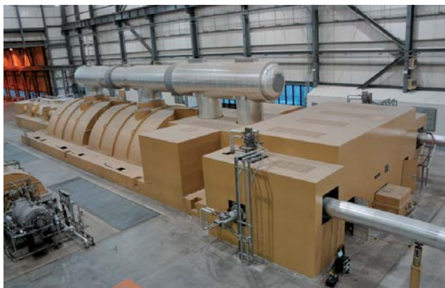
営業運転を開始した米国アイアタン発電所2号機のSTG
