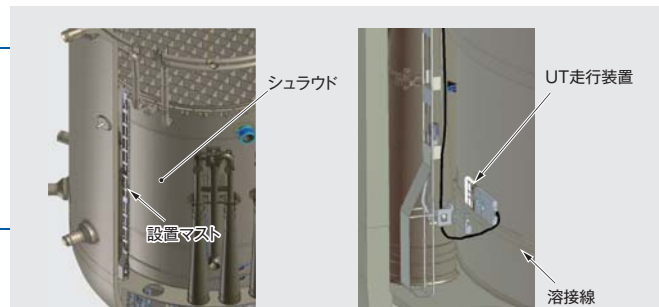
図1. 燃料交換中のシュラウド点検装置 — 設置マストをその下部に収納したUT走行装置とともに、シュラウド上部から据え付けます。その後、UT走行装置を探傷部位(溶接線)に位置決めし、ケーブルを送り出しながら、水平方向に走行させます。
