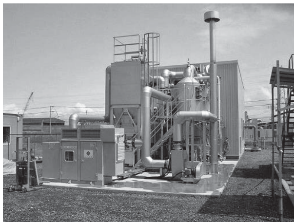
図2. 実証試験設備 — 脱水汚泥の処理容量が1.9 t/日規模の実証試験設備を用いて、システムの有効性を確認した。
