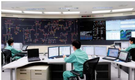
中央給電指令所システム
