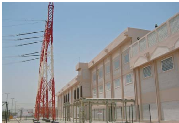
ラアス アル ハイマー変電所 Ras Al Khaima Grid Station, United Arab Emirates (UAE)
