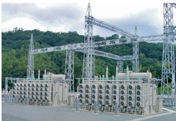
500 kV-1,000 MVA ASA 変圧器
