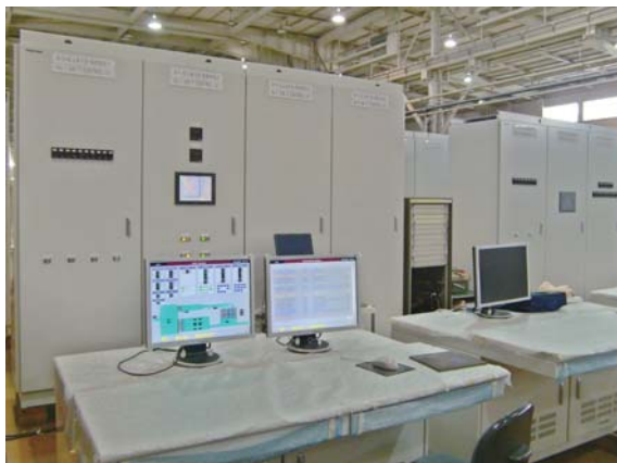
ナムグム2水力発電所 監視制御装置
