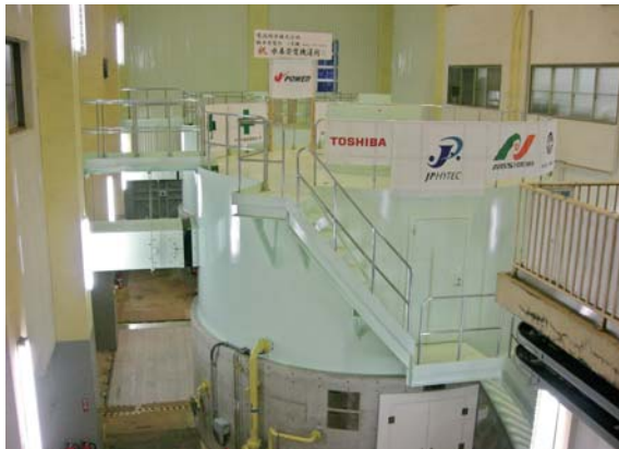
電源開発(株) 糠平発電所の1号発電機
