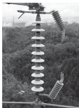
図8. 154 kV送電用避雷装置の据付け状況 — 154 kV 送電線の懸垂がいし連に設置されたホーン形送電用避雷装置の適用例である。
