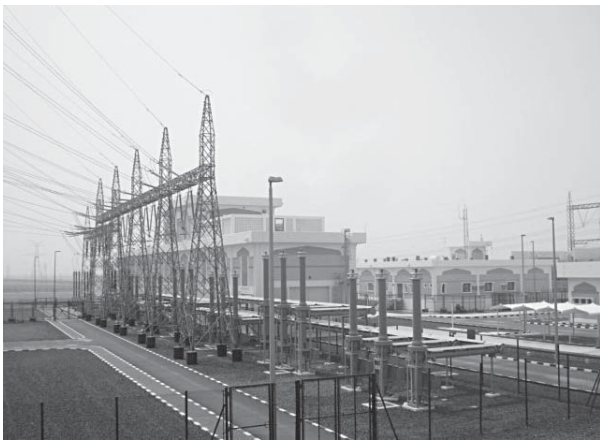
図5. 完成した245 kV GISと建屋 — 手前が増設部分、奥が既設部分である。
