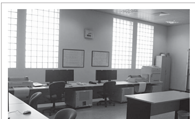
図3. SCMSが置かれた監視制御室 — スウェイハン変電所は、このSCMSで制御されている。
