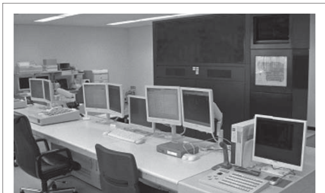
図7. システムを設置した制御室 — 実際にシステムを設置した制御室のようすを示す。東京電力(株)では、2008年5月より逐次運用を開始している。
