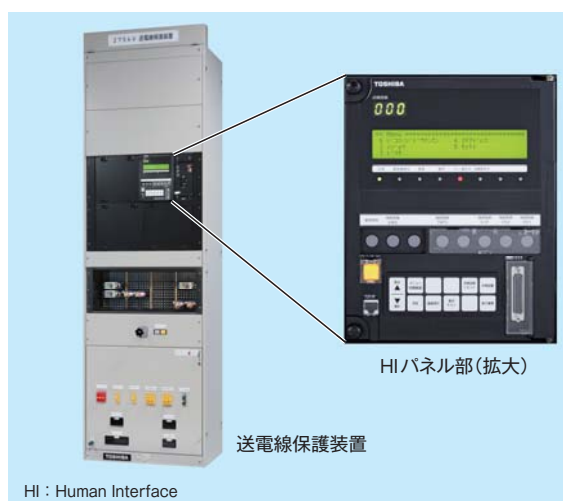
D4リレーを適用した保護装置 Protection relay equipment applying D4 relay
