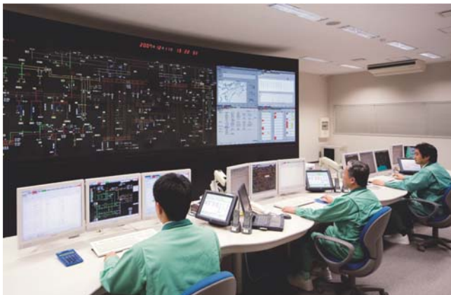
高知系統制御所システム Kochi Control Center System of Shikoku Electric Power Co., Inc.
