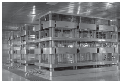
図6. 新信濃変電所 新1号FCの50 Hz側サイリスタバルブ — 無課電試験まで終了し、今後、系統連系試験を実施する。 50 Hz-side thyristor valve at Shin-Shinano Substation
