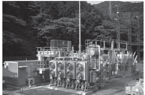
図2. SVCの全景 — 左端はサイリスタバルブ収納ハウスである。 Overview of SVC
