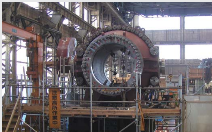
▲ 西龍池揚水発電所向け入口弁の工場組立 Factory assembly of inlet valve for Xilongchi Pumped-Storage Power Station
