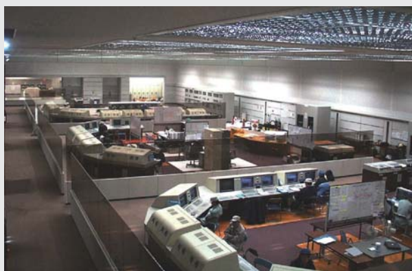
▲ 中央制御室 Central Control Room
