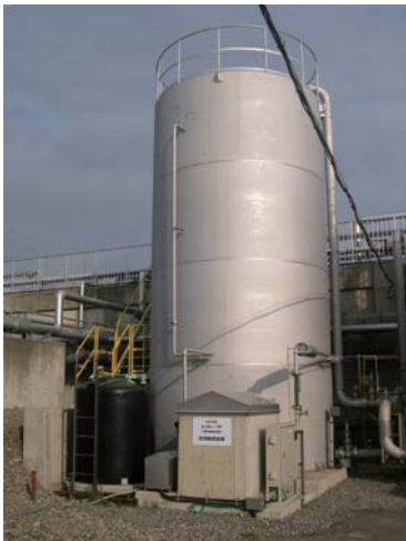
生物脱硫装置
