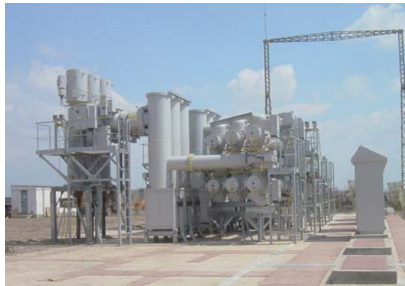
ルーマニア ブラジベスト変電所における420 kV GIS 420 kV gas-insulated switchgear (GIS) at Brazi Vest Substation, Romania
