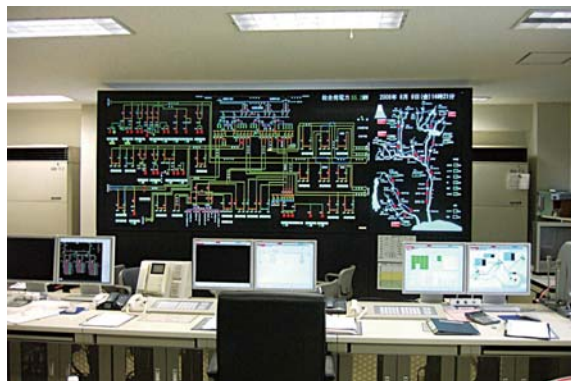
東京電力(株)松田制御所の制御室 Control room at Matsuda Control Center of The Tokyo Electric Power Co., Inc.
