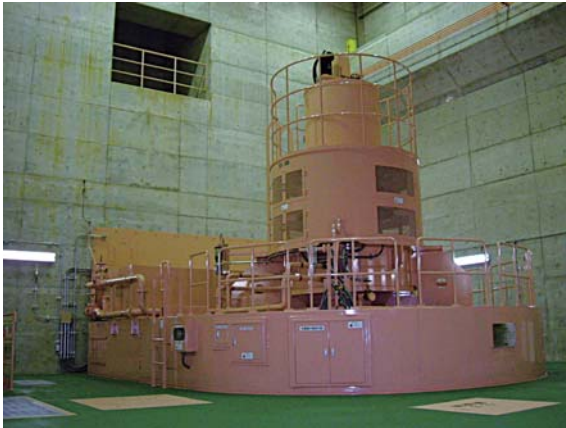
北海道電力(株)新忠別発電所 水力発電機室 Generator floor at Shinchubetsu Power Plant of The Hokkaido Electric Power Co., Inc.
