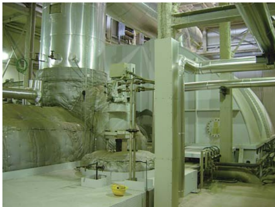
トルビスコサ発電所タービン全景 Overview of turbine for Torviscosa Power Plant, Italy
