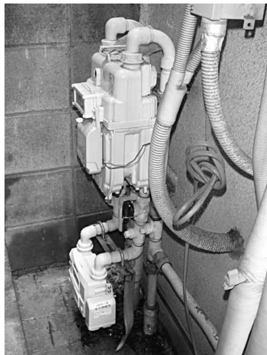
図9. フィールドテストのガスメーター設置状況—フィールドテスト中の超音波式ガスメーター(下側)の設置状況を示す。膜式ガスメーター(上側)に比べて、超音波式ガスメーターが小型であることがよくわかる。
